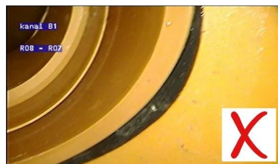
Obr.4 Nesprávně umístěné těsnění
